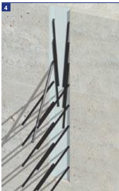
4 Endireite os varões utilizando a ferramenta de endireitamento Eazistrip. Os varões devem ser endireitados apenas uma vez.
